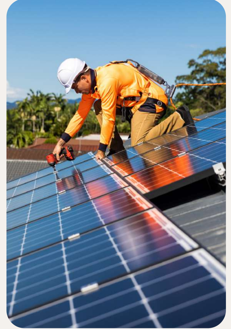
Büyük ve Orta Çaplı GES yada Çatı GES Tesisleri
